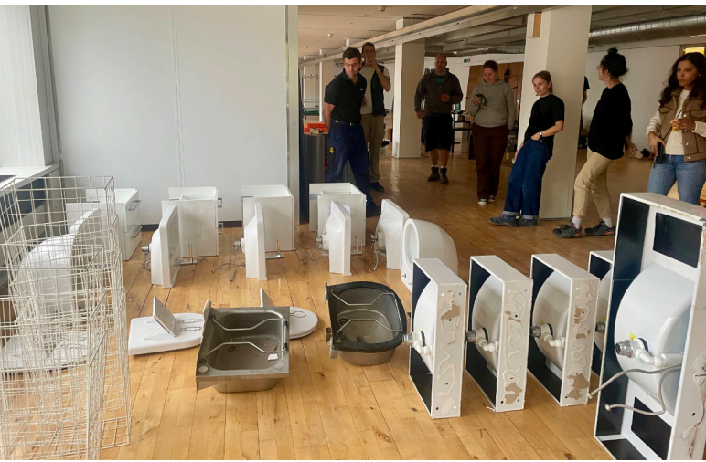
Visite de chantier le deuxième jour du cours : les participant·es dressent un inventaire des éléments de construction.
